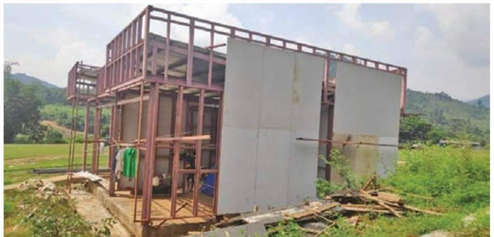
หนึ่งในหลายร้อยอาคาร USO Net ที่สร้างไม่เสร็จ
