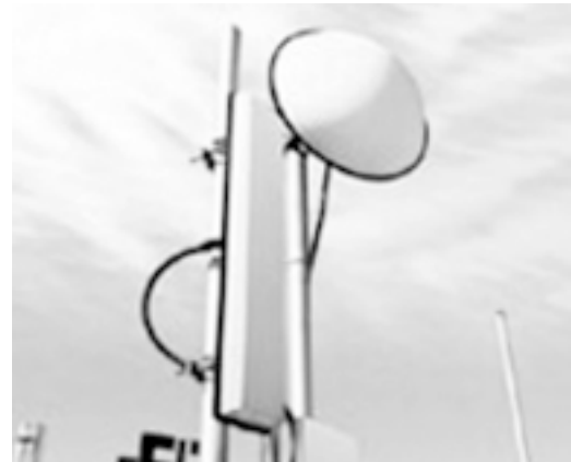
รูปที่ 10 : สถานีแม่ข่าย (Base Station หรือ BS) ในระบบ WiMAX
