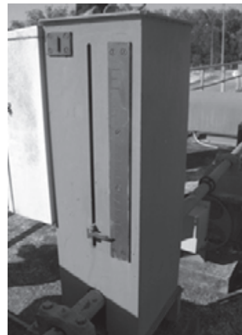
รูปที่ 2.6 อุปกรณ์วัดระยะยกบานประตูระบายน้ำ (gate position indicator)
