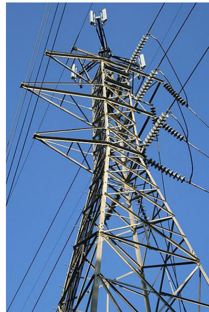
เสารองรับสายส่ง ไฟฟ้าแรงสูง
